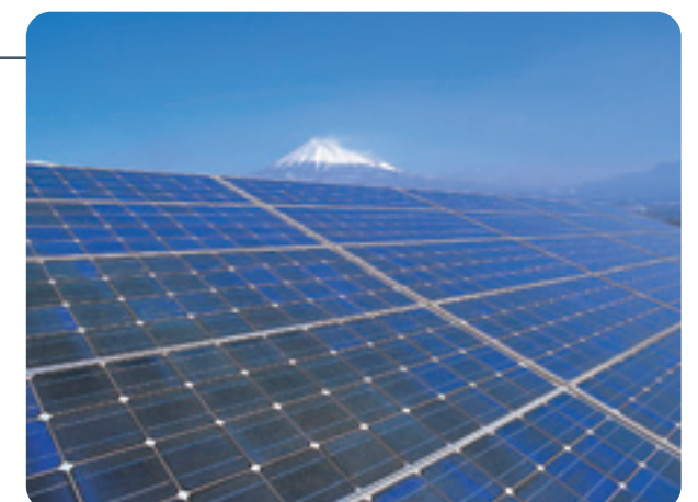
東京電力(株) 太陽光発電設備<静岡>
